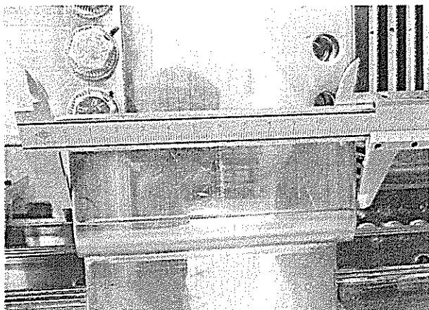
主断路器进出线宽度照片
